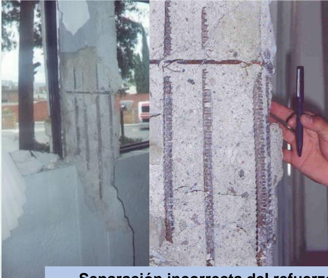
Separación incorrecta del refuerzo transversal
