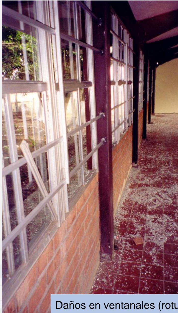
Daños en fachada
